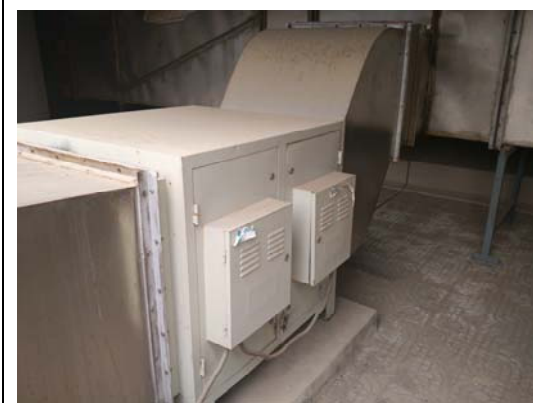
南楼食堂油烟净化器
