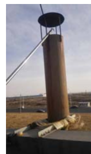
1#设备房锅炉烟囱
