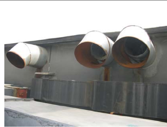
北楼锅炉烟囱
