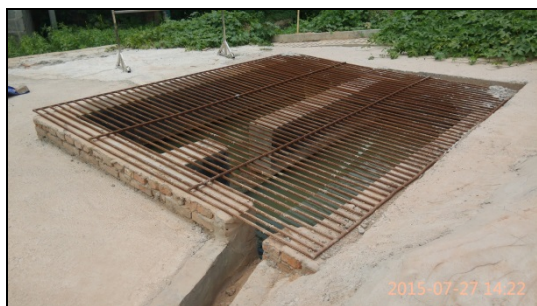
车辆段二级沉淀池
