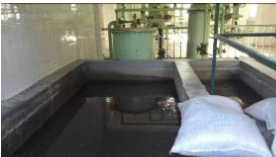
软化水间盐池
