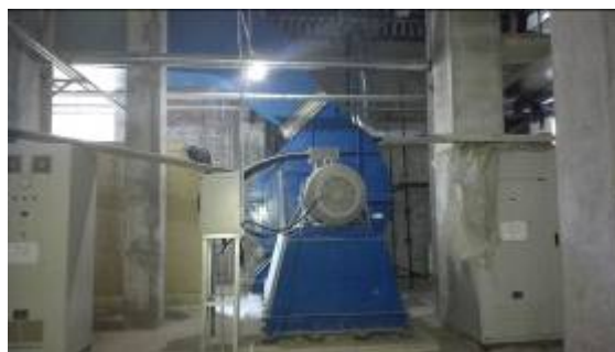
南锅炉房鼓风机
