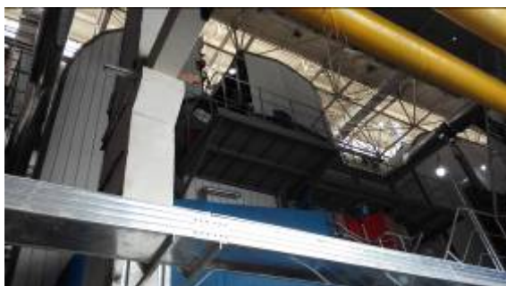
南锅炉房低氮燃烧装置
