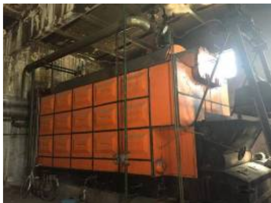
现有工程 4.2MW 燃煤热水锅炉
