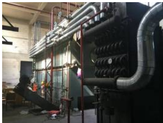
现有工程 7.0MW 燃煤热水锅炉
