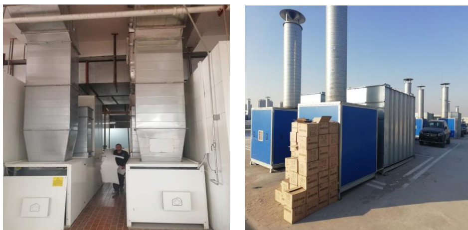
图7 拟建喷漆间废气处理设备
