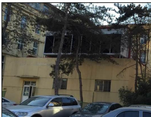
图 2.2-2 现有冷却塔照片
