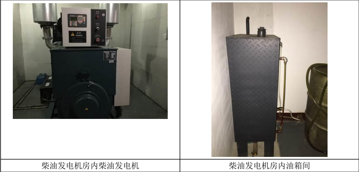
图 2.2-3 现有柴油发电机房照片
