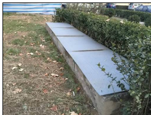
现有污水处理站地理式结构臭气排口
