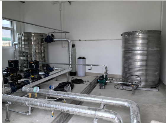
电锅炉房内部
